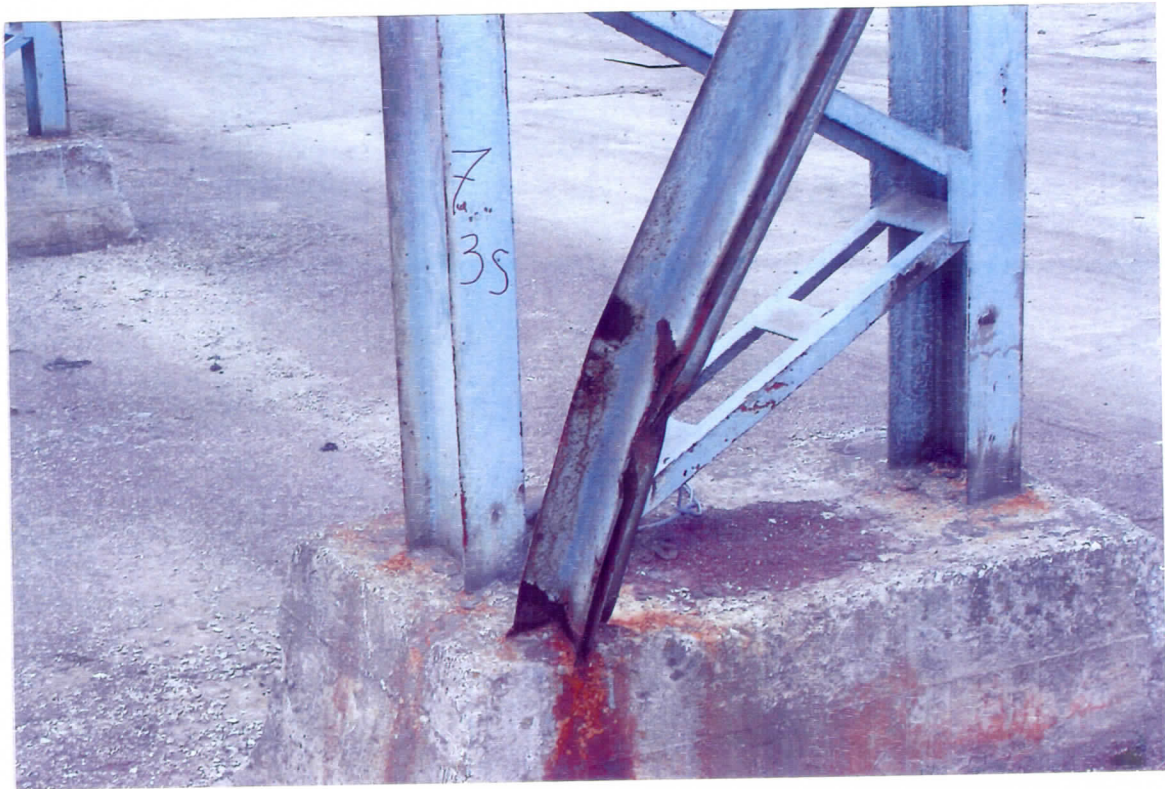
Rys 52 Zniszczenia i korozja stężenia słupów estakady.
