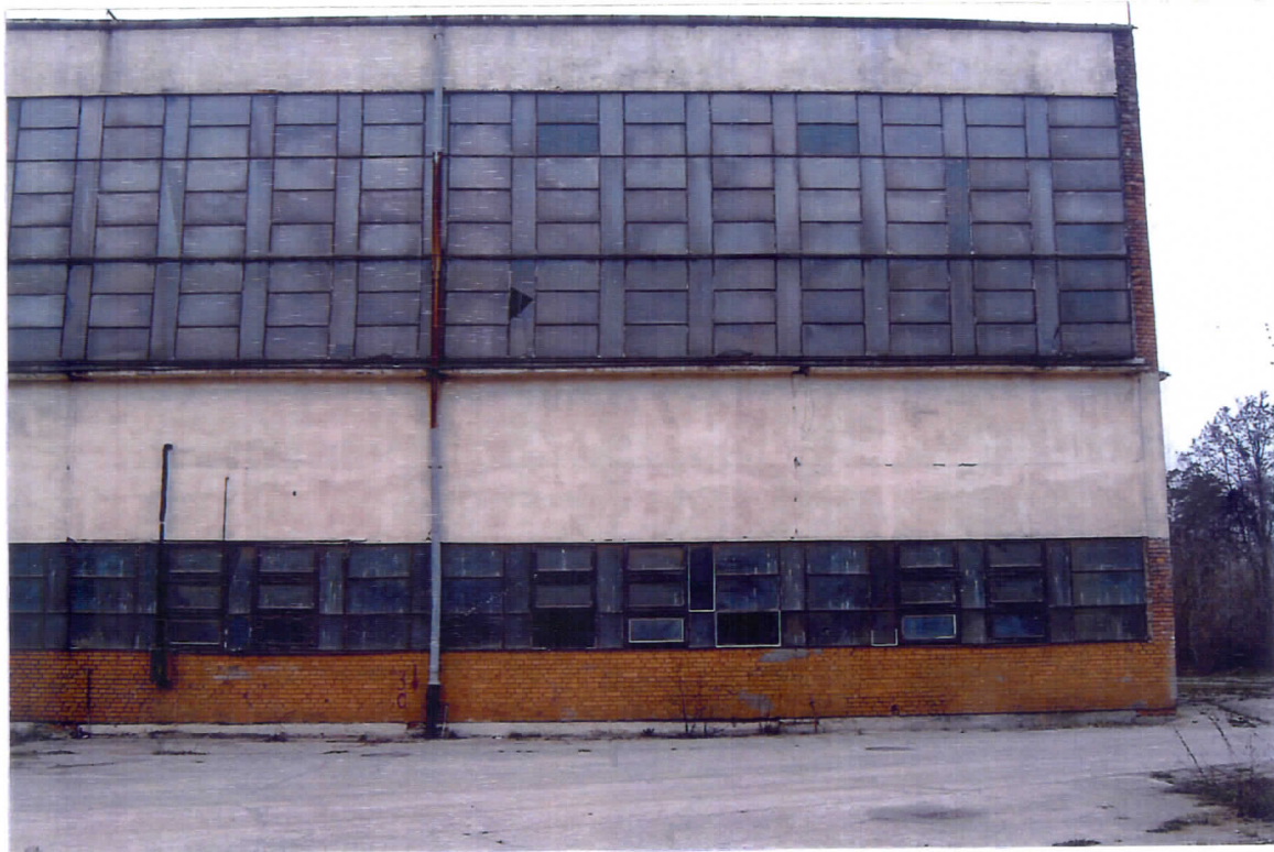
Rys 1 Widok zewnętrznej ściany południowej przy ścianie szczytowej Hali 1. Widoczne odspojenie ściany szczytowej i rysy pomiędzy prefabrykowanymi płytami ściennymi.
