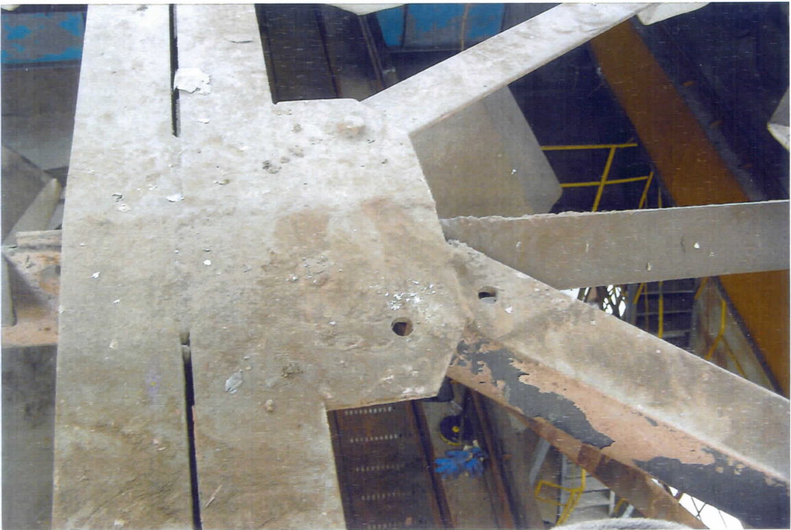
Rys 20 Rozerwane połączenie stężenia pałociowego w osi.
