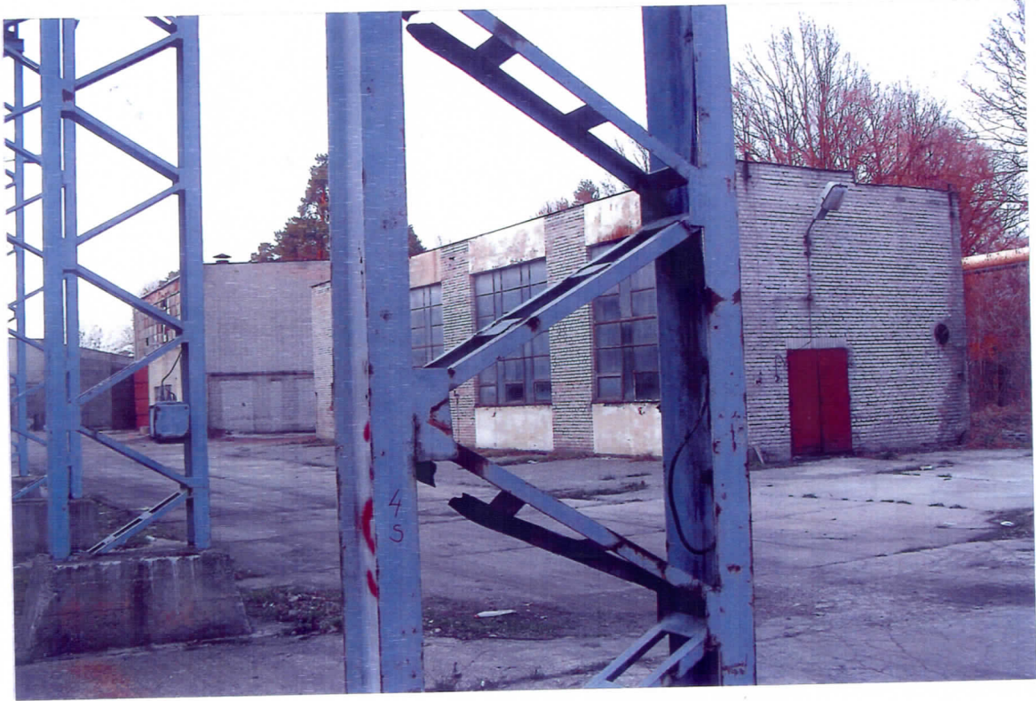
Rys 51 Szczegół zniszczenia kraty słupa estakady.
