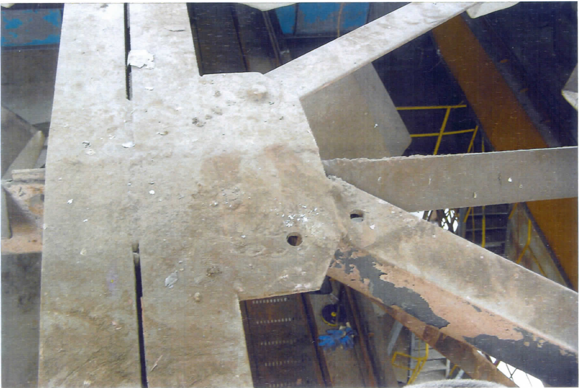
Rys 20 Rozerwane połączenie stężenia połączniowego w osi.
