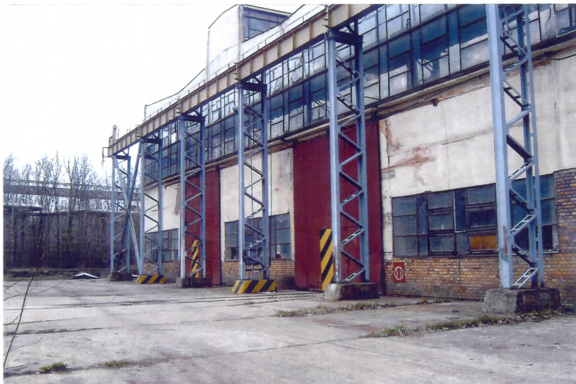
Rys 4 Widok zewnętrznej ściany południowej w osiach 1-5 . Widoczne rysy pomiędzy prefabrykowanymi płytami ściennymi.
