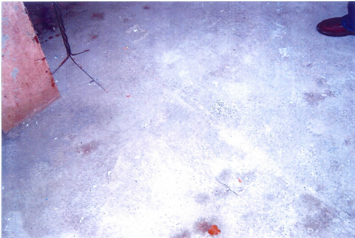
Rys 39 Rysa na podłodze przy krawędzi słupa hali 1.
