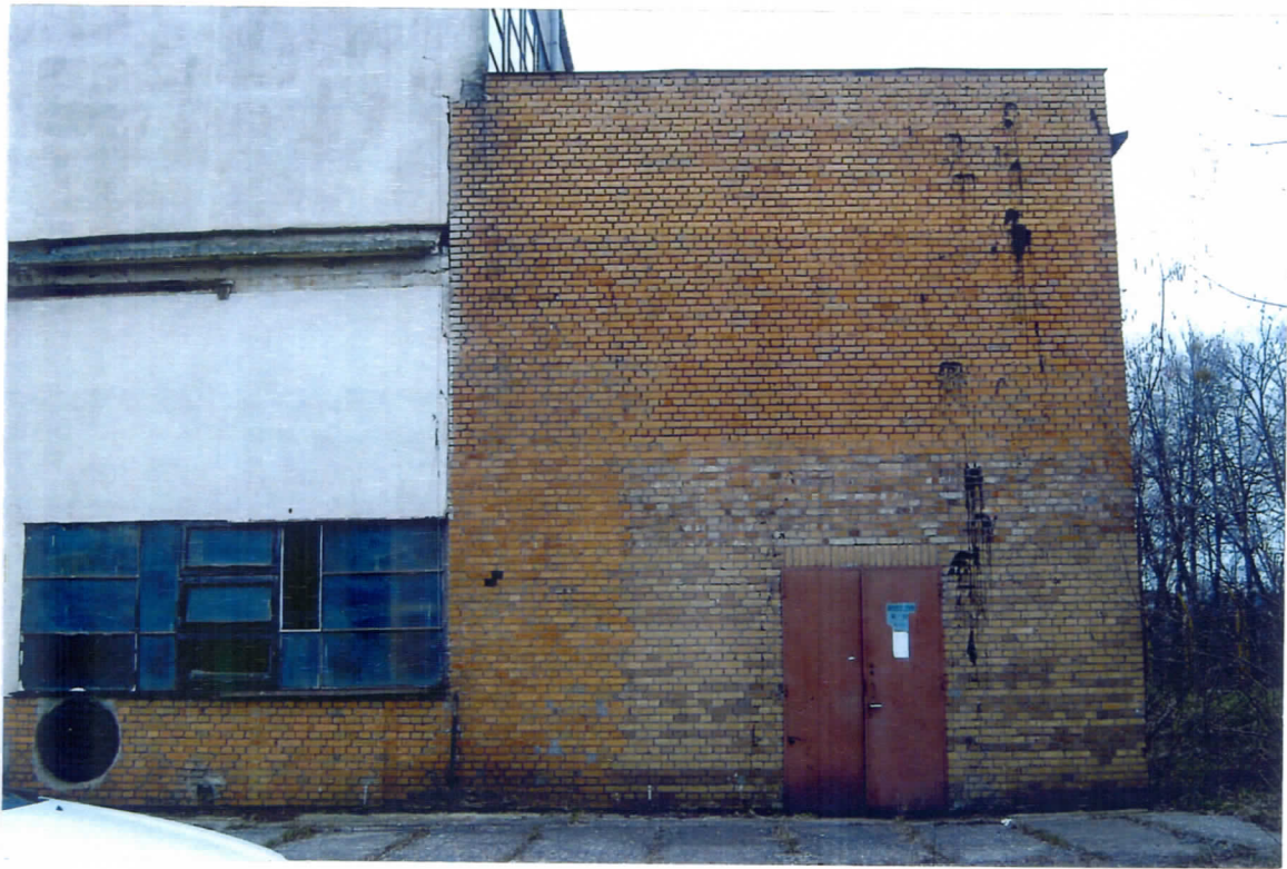
Rys 7 Widok zewnętrznej ściany wschodniej, szczytowej, hali 1 i budynku biurowego. Widoczne odspojenie ściany szczytowej hali 1.
