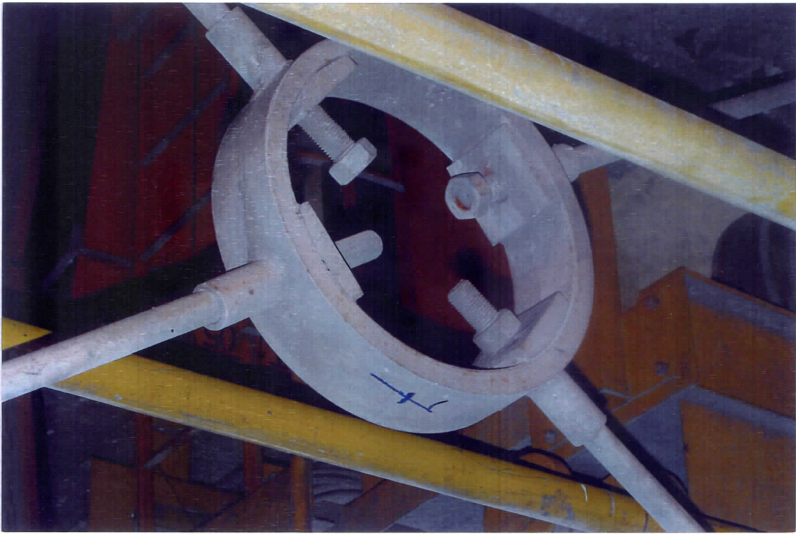
Rys 27 Szczegół stężenia pionowego hali 1. Widoczne nie dokręcone śruby.
