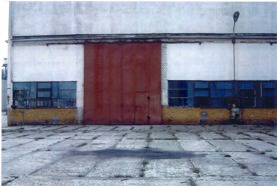
Rys 9 Widok zewnętrznej ściany wschodniej hali 1 i budynku biurowego. Widoczne odsłonięcie ściany szczytowej hali.
