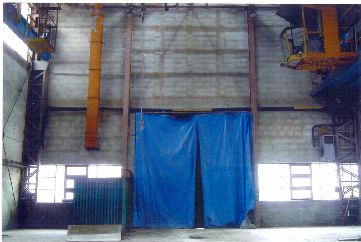
Rys 10 Widok od strony wewnętrznej ściany wschodniej hali 1. Widoczne przemarzanie ściany z gazobetonu.
