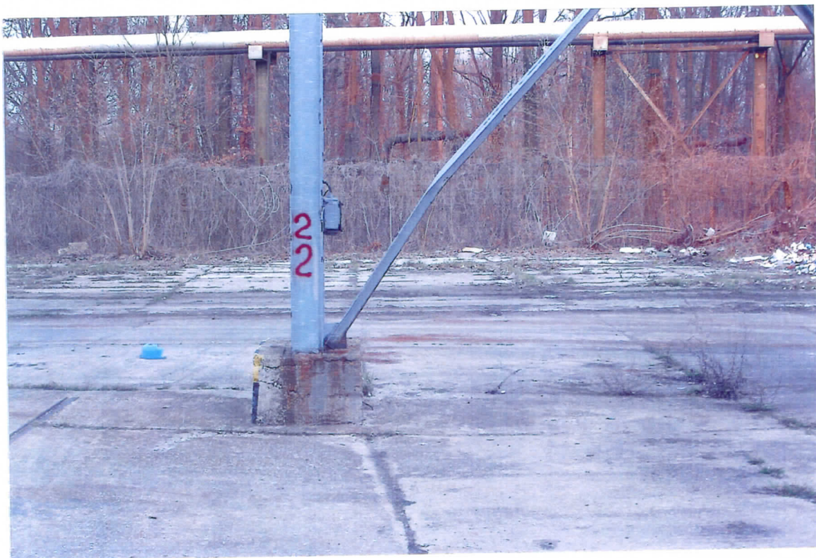
Rys 56 Zniszczenia stężenia słupów estakady.
