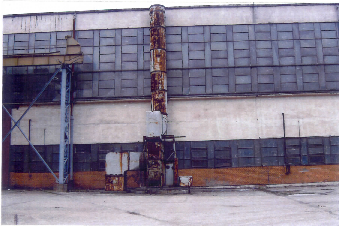
Rys 2 Widok zewnętrznej ściany południowej Hali 1 . Widoczne rysy pomiędzy prefabrykowanymi płytami ściennymi.
