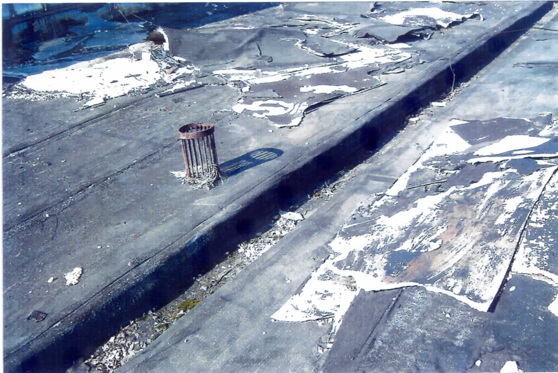
Rys 13 Widok pokrycia dachu hali 1. Widoczne zniszczenie pokrycia i koryta odprowadzającego wodę z dachu.
