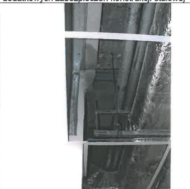
4. Instalacje uniemożliwiające wykonanie dodatkowych zabezpieczeń konstrukcji stalowej
