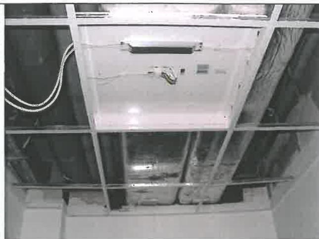
2. Instalacje uniemożliwiające wykonanie dodatkowych zabezpieczeń konstrukcji stalowej
