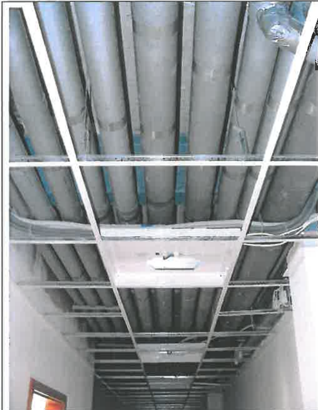
5. Instalacje uniemożliwiające wykonanie dodatkowych zabezpieczeń konstrukcji stalowej
