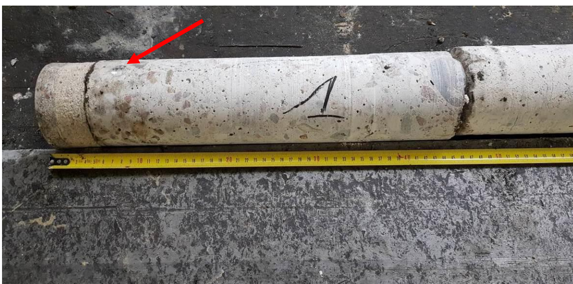
Fot. 1. Widok rdzenia dla przewiertu w lokalizacji nr 1 – fragment posadzki z fundamentem z widocznym zbrojeniem w części stropowej (strzałka).
