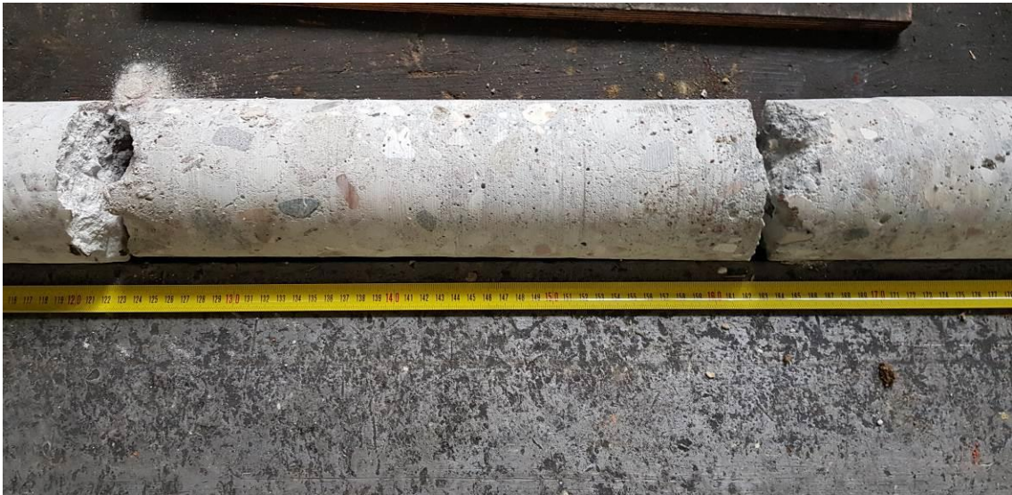
Fot. 3. Widok rdzenia dla przewiertu w lokalizacji nr 1 – cd. środkowej części rdzenia fundamentu.
