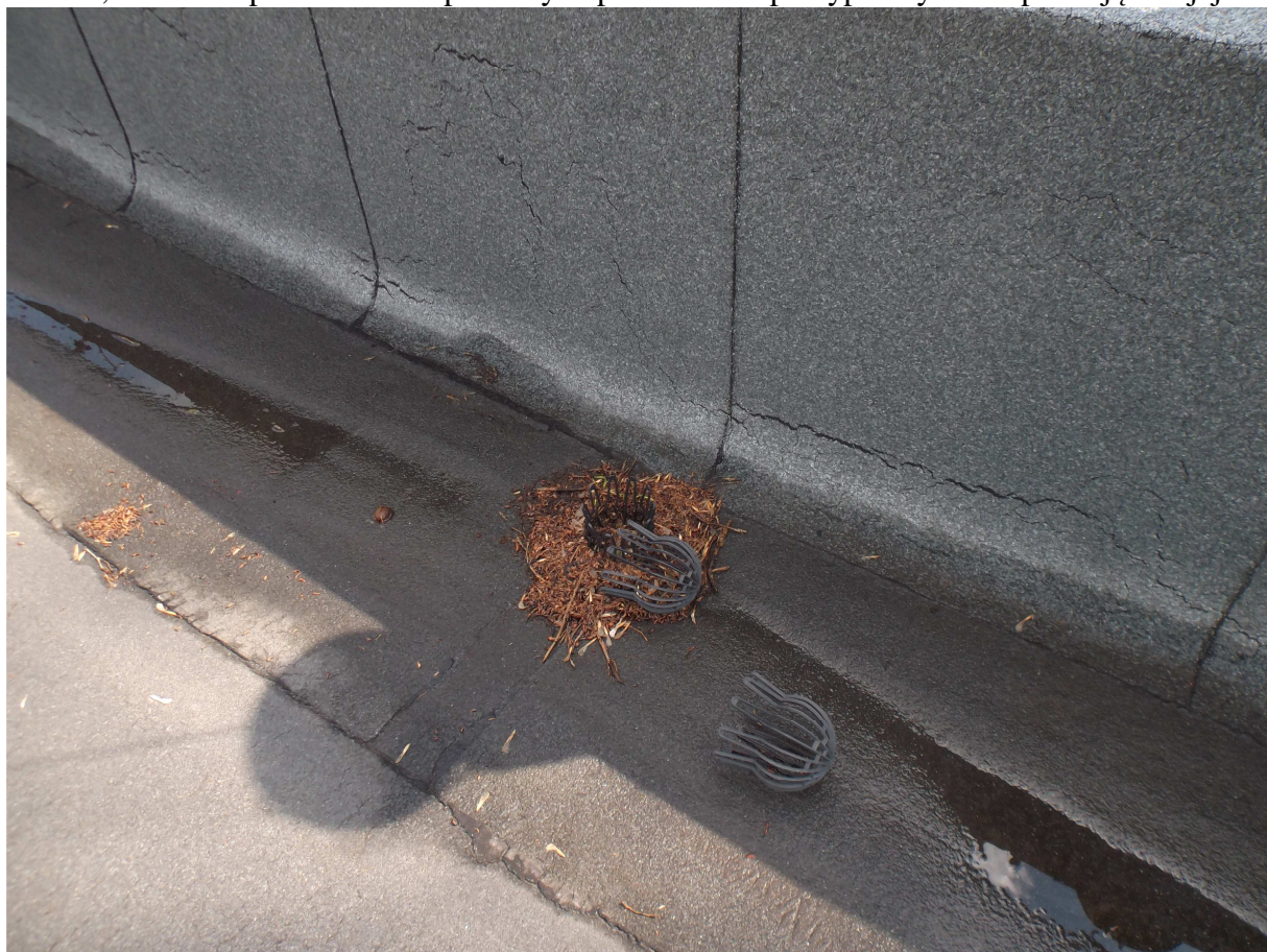
Fot. 11, 12. Zabezpieczenia rur spustowych przed liśćmi powypadały i nie spełniają swojej funkcji.
