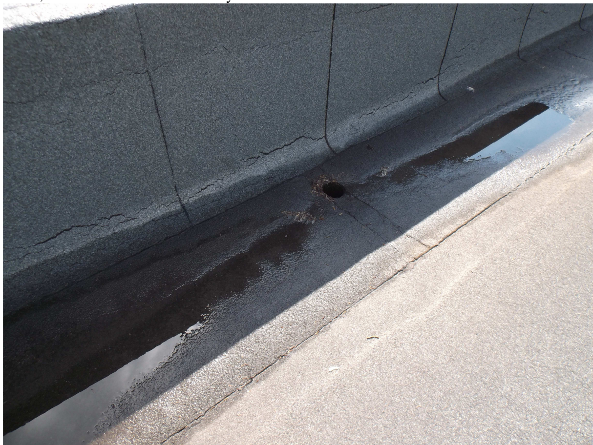
Fot. 9, 10. Widoczne zastoiska wody.
