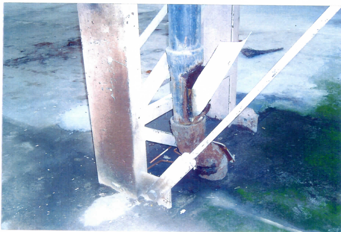
34 Odprowadzenie wody z dachu hali 1.
