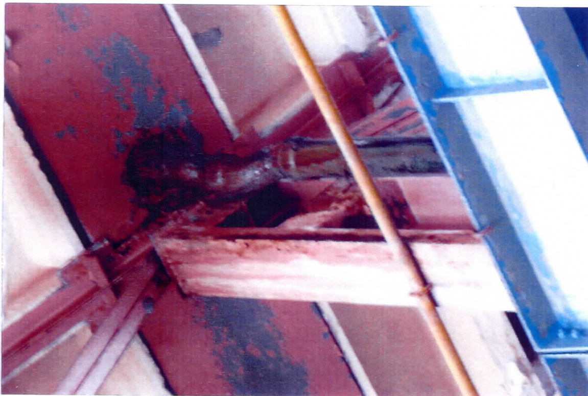
Rys 35 Odprowadzenie wody z dachu hali 1. Widoczna korozja elementów podparcia wiązarów.
