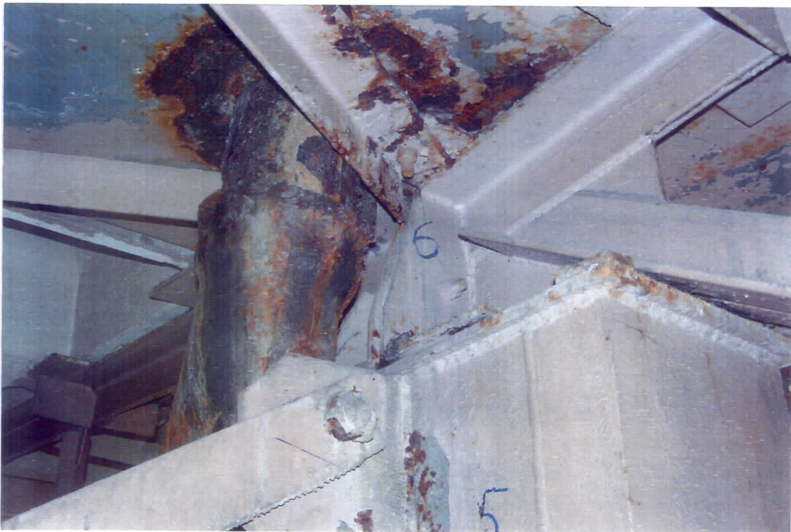
Rys 28 Odprowadzenie wody z dachu hali 1. Widoczna korozja podpory wiązarów.
