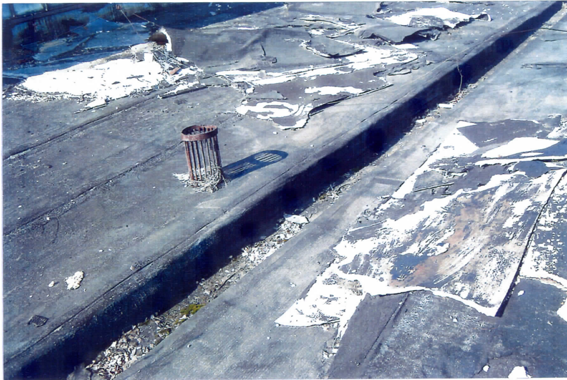
Rys 13 Widok pokrycia dachu hali 1. Widoczne zniszczenie pokrycia i koryta odprowadzającego wodę z dachu.
