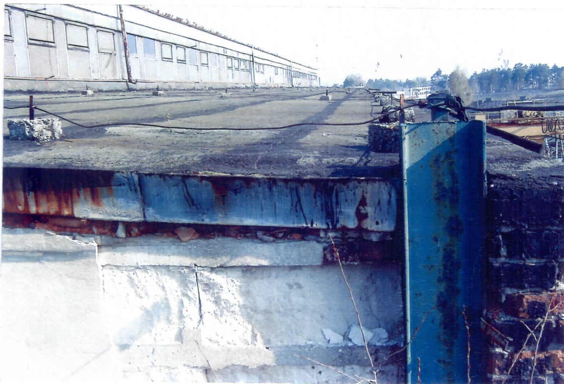
Rys 14 Widok uszkodzenia gzymsu ściany szczytowej.
