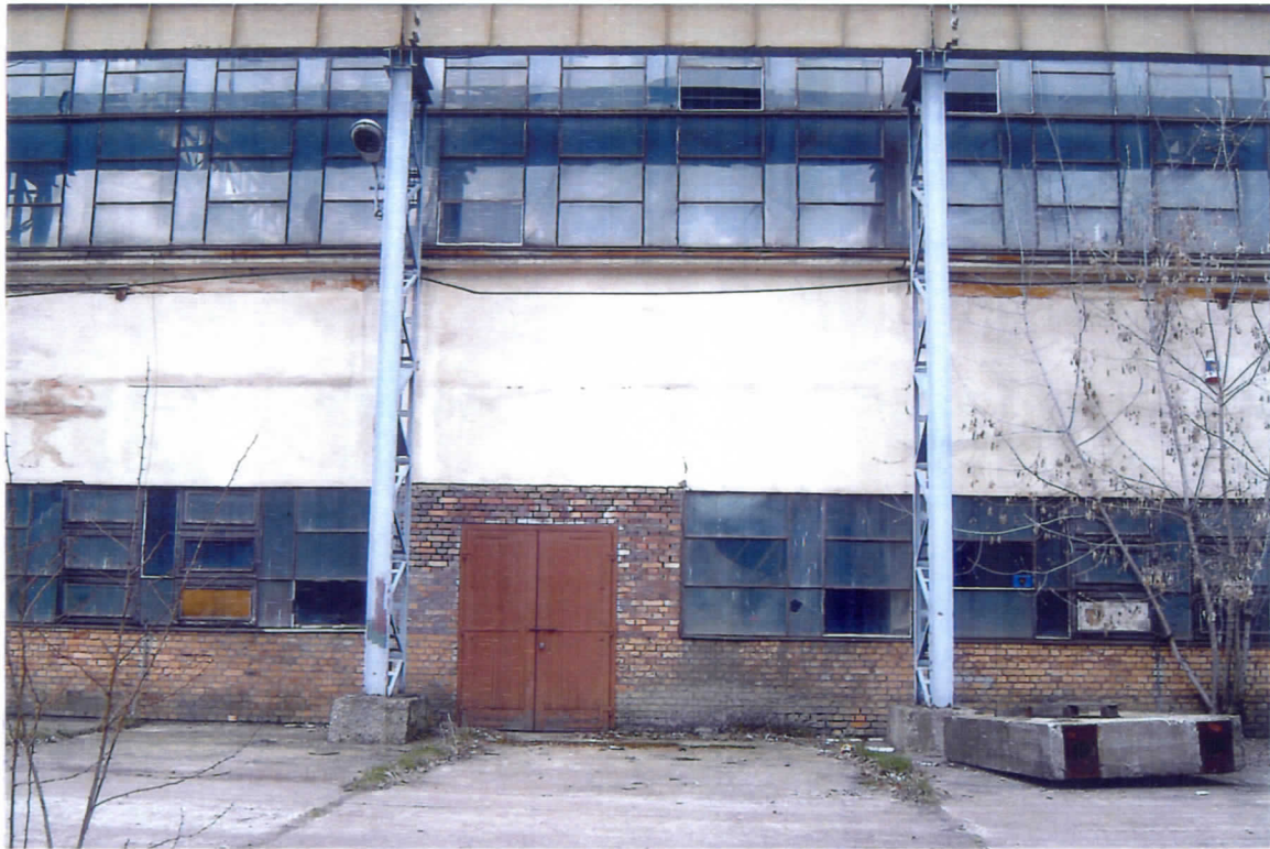
Rys 3 Widok zewnętrznej ściany południowej w osiach 2-4 . Widoczne rysy pomiędzy prefabrykowanymi płytami ściennymi.
