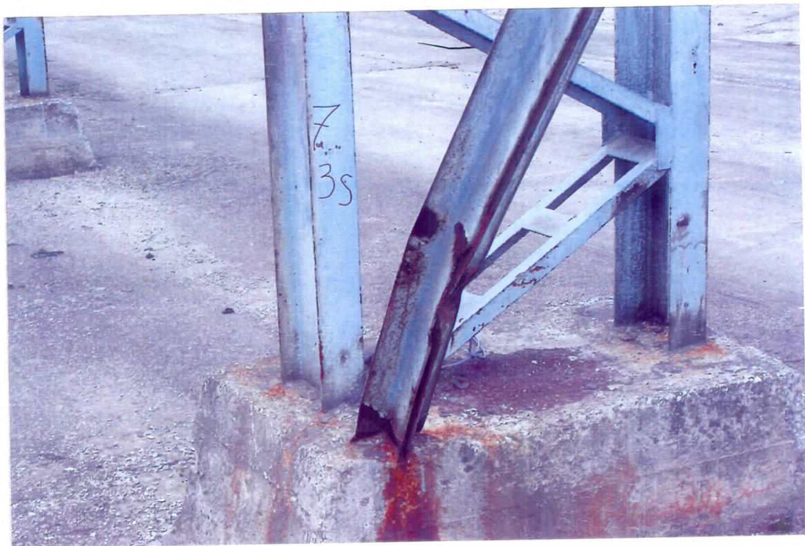
Rys 52 Zniszczenia i korozja stężenia słupów estakady.
