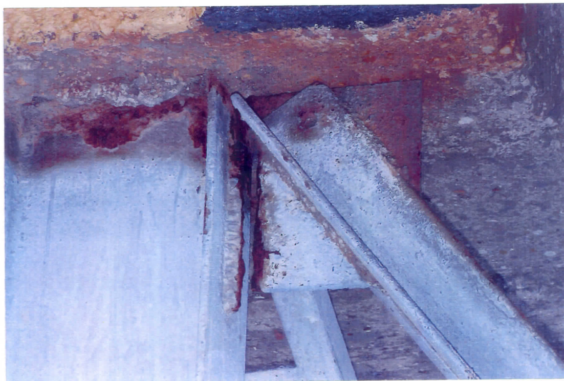
Rys 58 Korozja wżerowa podpory słupa i stężenia estakady.
