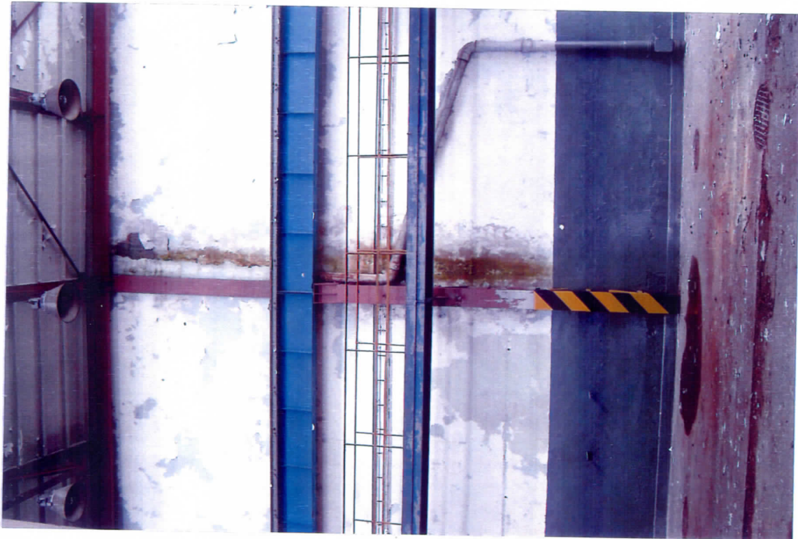
Rys 37 Odprowadzenie wody z dachu hali 1. Widoczna korozja rury spustowej.
