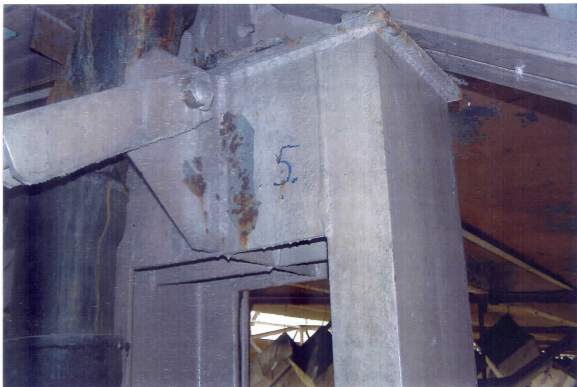
Rys 29 Korozja elementów stężenia pionowego usytuowanego pod odprowadzeniem wody z dachu hali 1.
