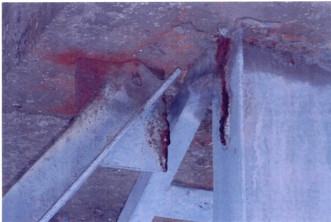
Rys 57 Korozja wżerowa podpory słupa i stężenia estakady.
