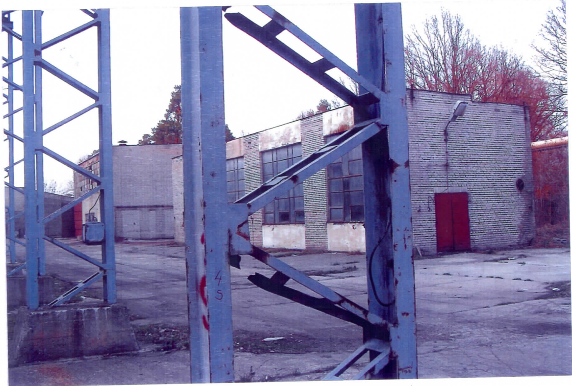
Rys 51 Szczegół zniszczenia kraty słupa estakady.
