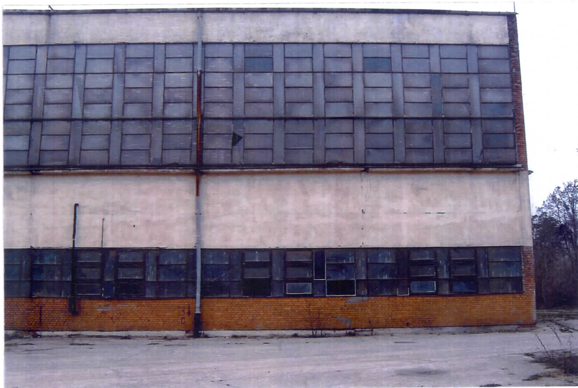
Rys 1 Widok zewnętrznej ściany południowej przy ścianie szczytowej Hali 1. Widoczne odspojenie ściany szczytowej i rysy pomiędzy prefabrykowanymi płytami ściennymi.
