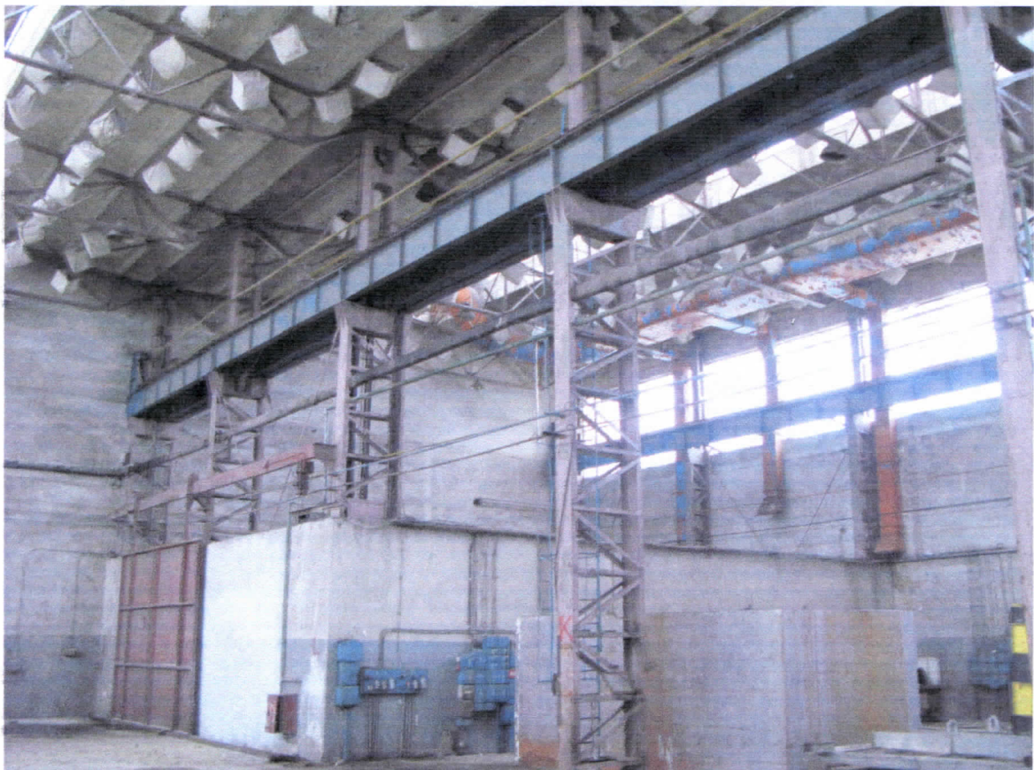
Fot. 2. Belki podsuwnicowe na środkowych słupach – najbardziej wyężone
