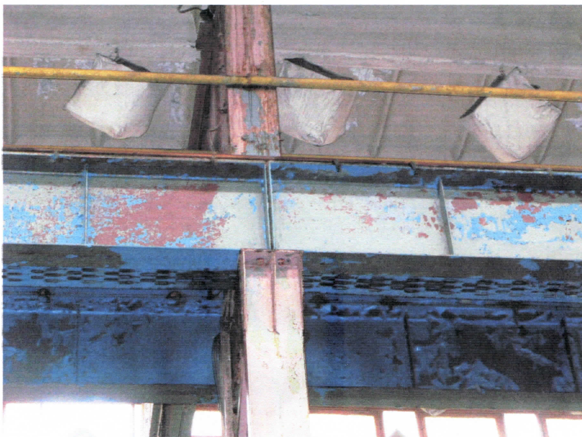
Fot. 3. Szczegóły mocowania belek podsuwnicowych- niedostateczne mocowanie belek do słupów – do przeprojektowania
