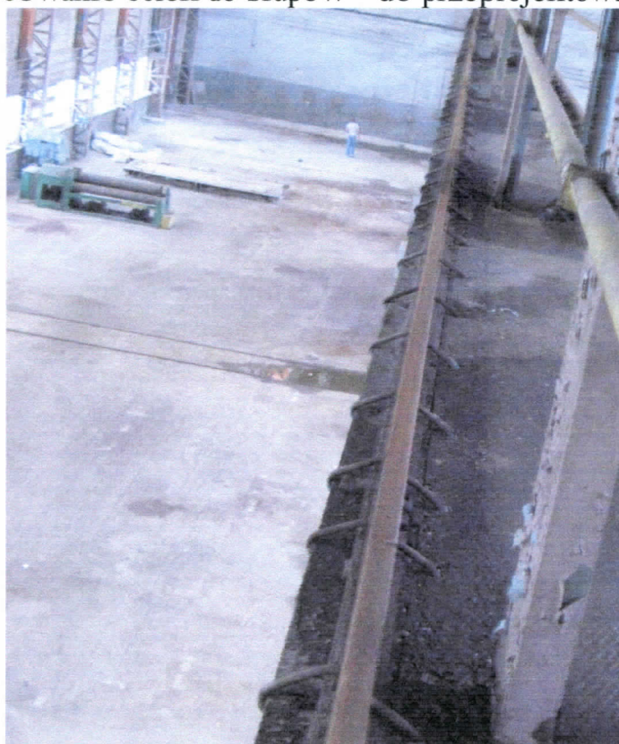
Fot. 4. Widok źle zamocowanych torów jezdnych suwnicy – do demontażu
