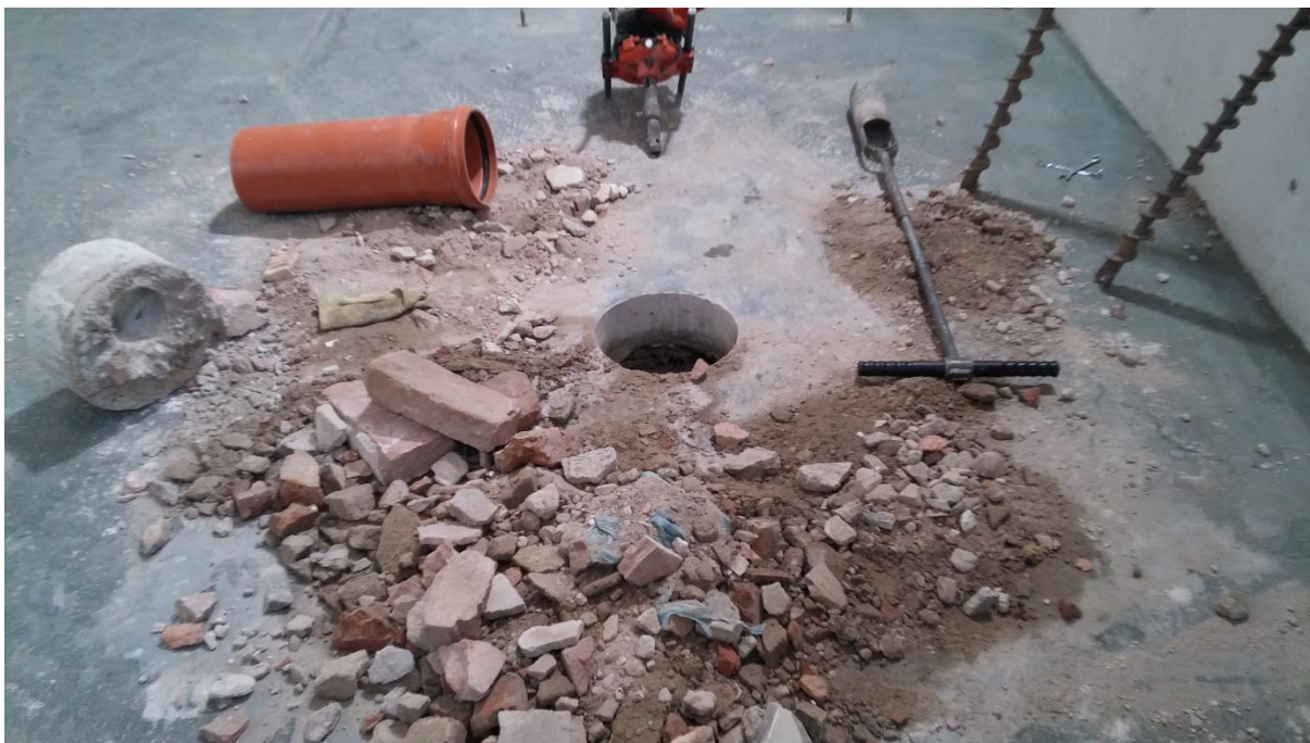
Fot. 7. Widok z etapu przewiertu podbudowy w pkt. 1 – urobek to nasyp gruzowo-ceglany rozluźniony, pozostałość po starych fundamentach.
