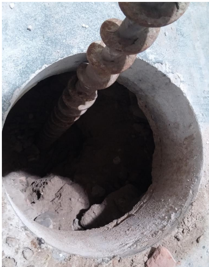
Fot. 6. Widok z etapu przewiertu w pkt. nr 1 – w dnie otworu widoczny obsypujący się rozluźniony nasyp.
