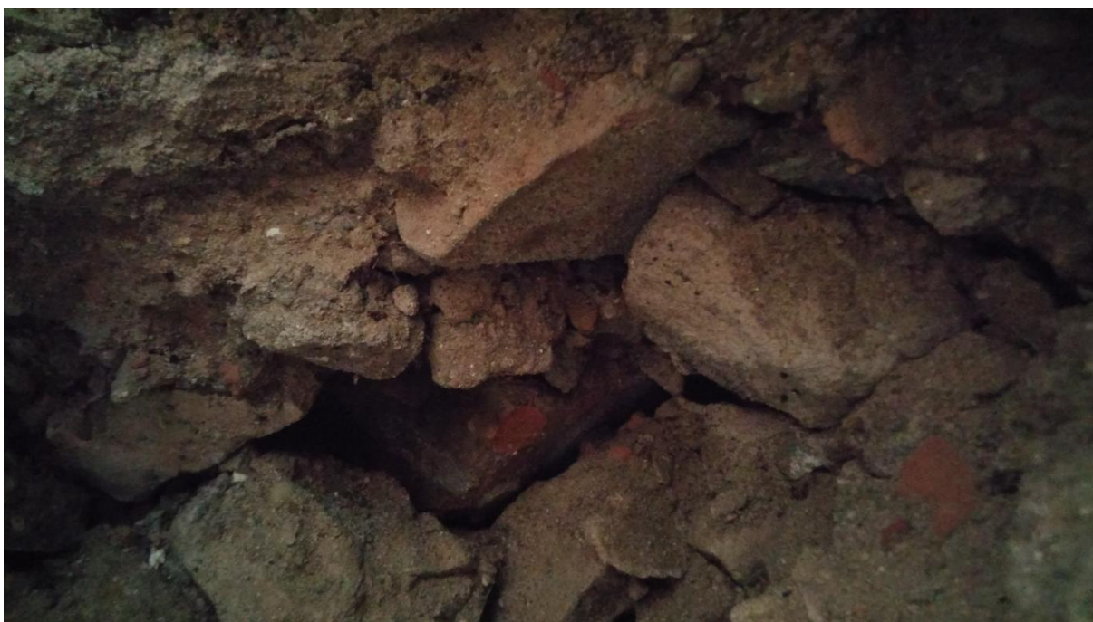
Fot. 8. Widok podbudowy w pkt. 1 – nasyp gruzowo-ceglany z licznymi szczelinami, zdjęcie wykonano w otworze.
