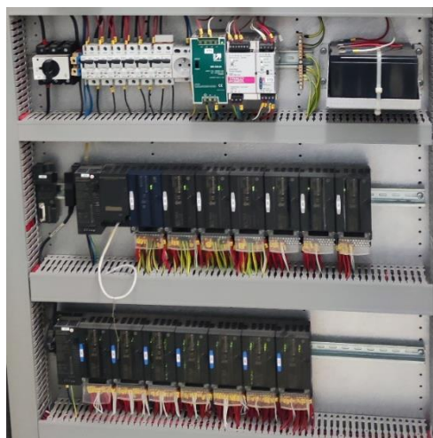
Rys. 12 Rzeczywisty wygląd szafy sterowniczej przepustnic wentylacji obiektu.
