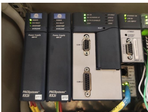
Rys. 7 Sterownika logicznego szafy F3'.
